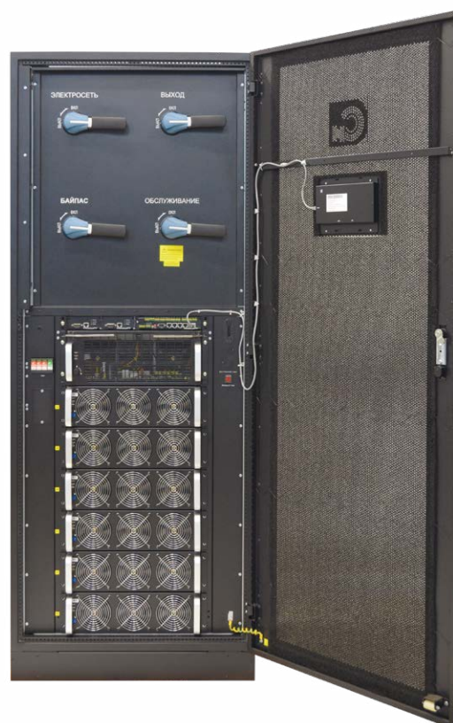
Кабинет ИБП 600 кВА
