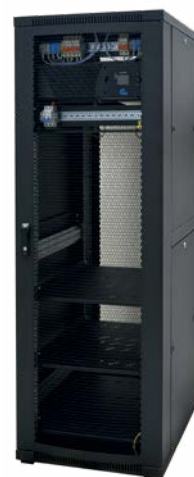
19" шкаф с оборудованием
