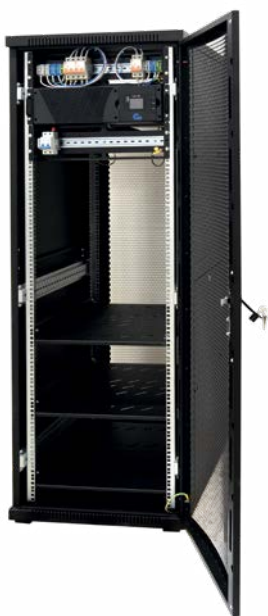
19" шкаф с оборудованием
