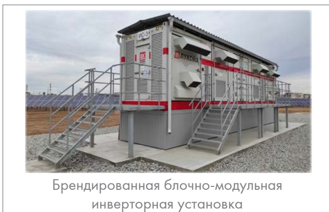
Блочно-модульная инверторная подстанция в климатическом контейнере
