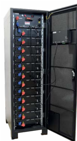
Шкаф с батарейными модулями
